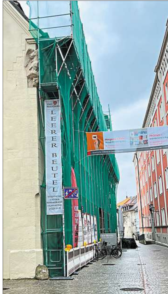
Mit Gerüst und Netz: Die Baustellen-Atmosphäre am Leeren Beutel bleibt der Bertoldstraße wohl bis Ende 2025 erhalten. Foto: Tino Lex
